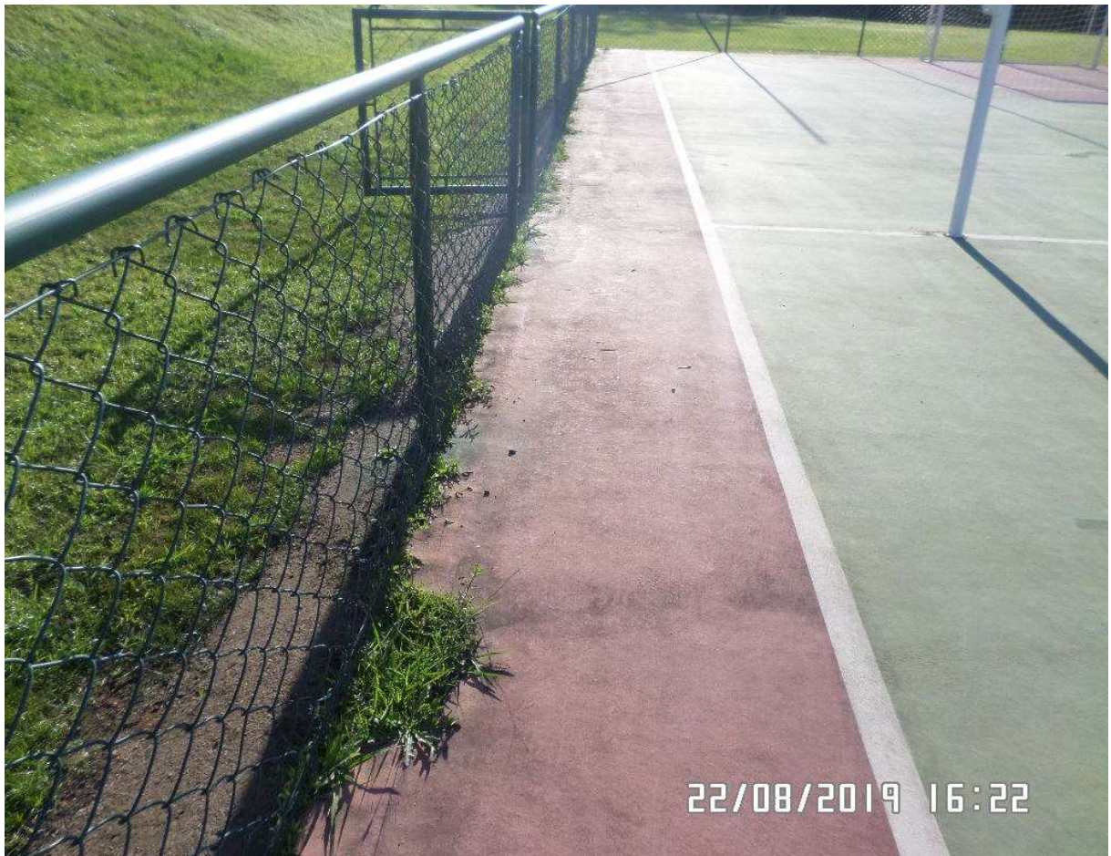
Quadra Poliesportiva - Trecho quebrado e com vegetação
