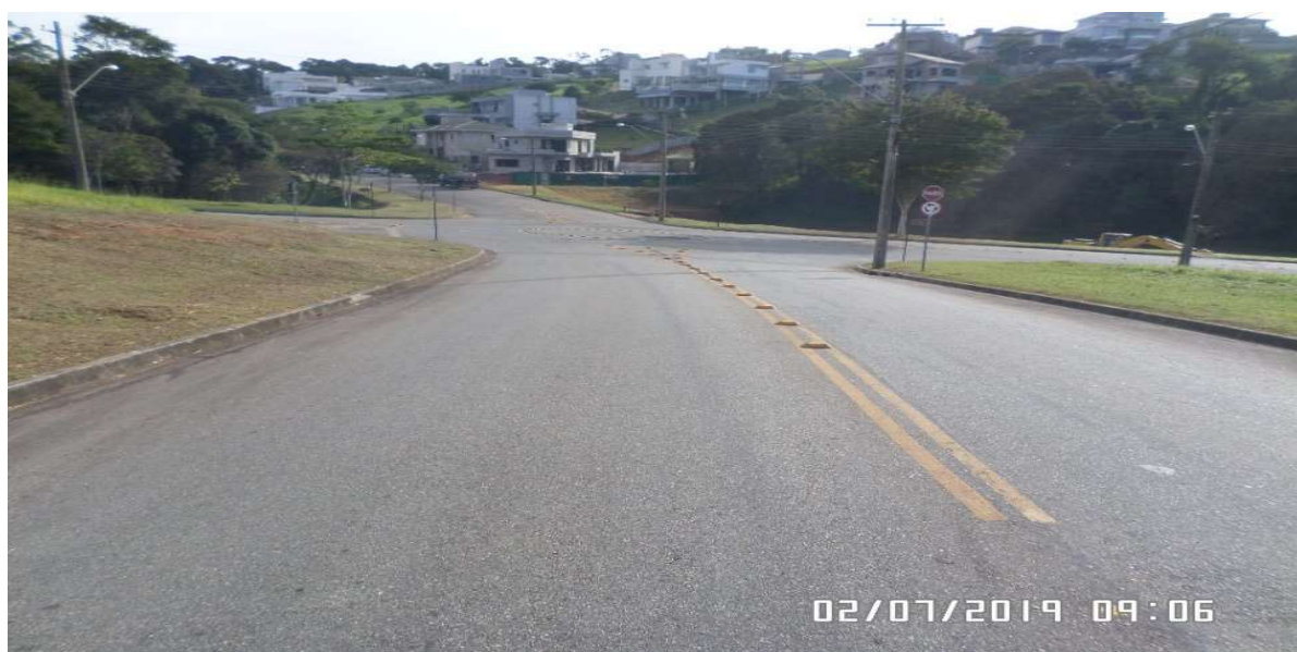
Rua Como - Sinalização deteriorada pelo decurso do tempo
