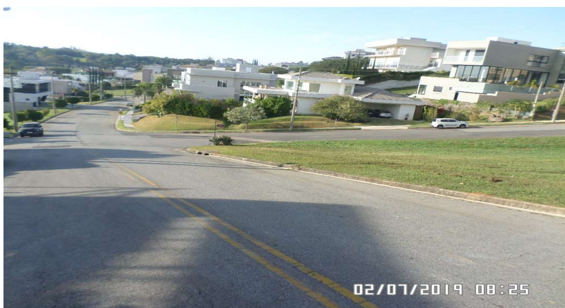
Rua Belluno - Sinalização deteriorada pelo decurso do tempo
