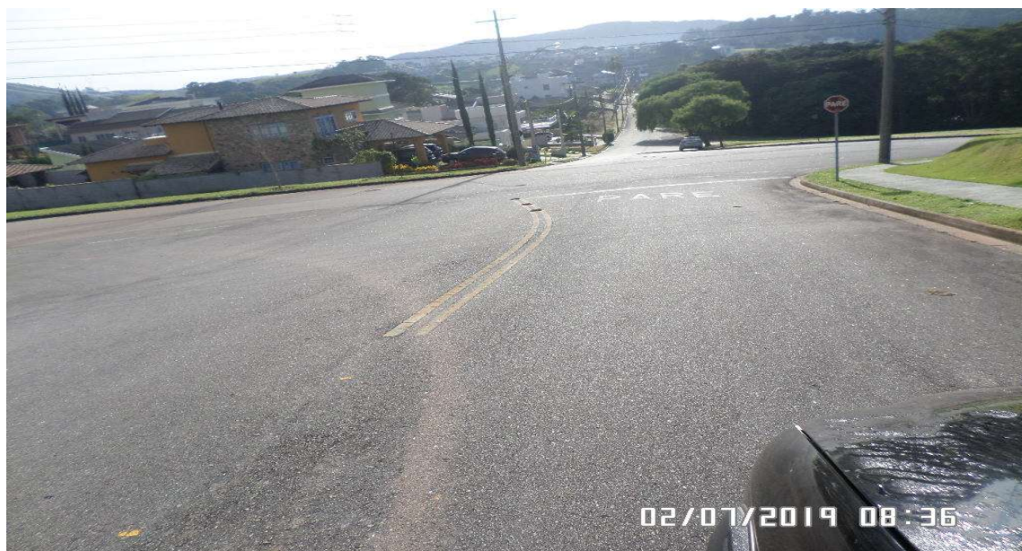
Rua Ferrara - Sinalização deteriorada pelo decurso do tempo
