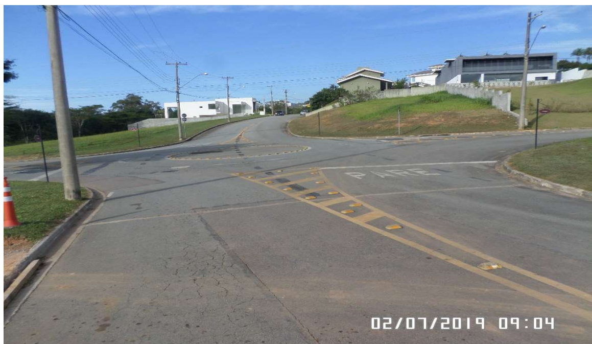
Rotatória das Ruas Como, Siena e Trento - Sinalização deteriorada pelo decurso do tempo
