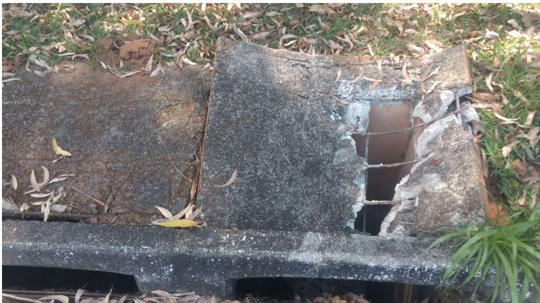
Tampa de boca de lobo danificada
