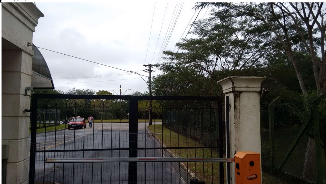
Danos na pintura
